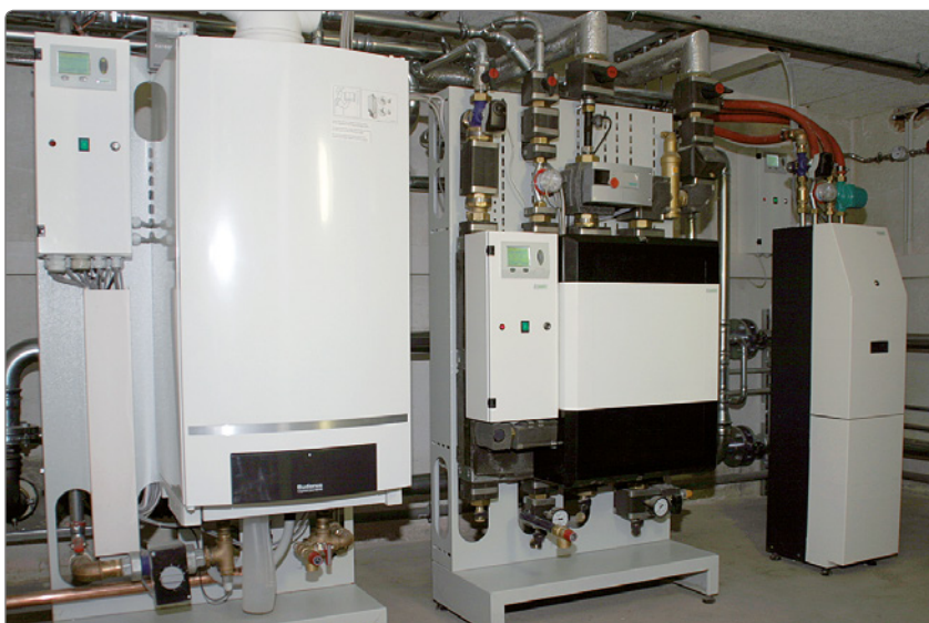
Im engen Zusammenspiel vom Keller bis zum Dach: PEWO Wärmeverteilsysteme, wie hier in Erlangen, sind modular aufgebaut. Die Solarstation pewoLoad S mit Solarertragserhöhung steht rechts im Bild.
