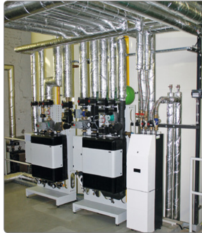
Bild: Thermische Solaranlage 200 m 2 mit Solarstation pewoLoad S
