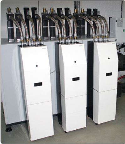
Bild: Kaskade 7 Wärmepumpen pewoTitan mit jeweils 20 kW
