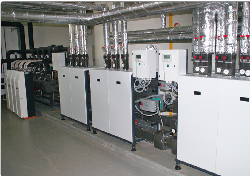
Bilder: Das Wärmeverteilsystem pewoSwitch mit 2 x Vorlauf und 2 x Rücklauf verteilt die Wärmeströme zwischen 11 Wärmeerzeugern und 6 Wärmeverbrauchern auf verschiedenen Temperatur-Niveaus.
